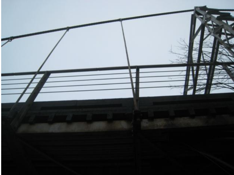
kuva 8. Riipputangon solki on valunut yläpäästään silminnähden pahasti
