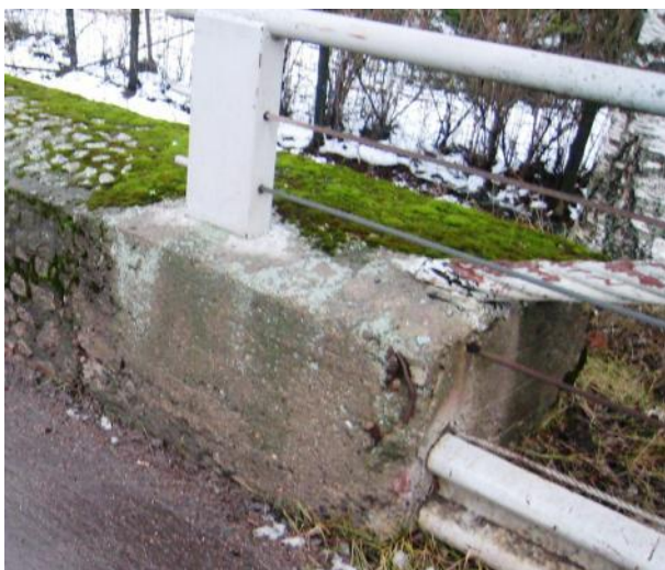
kuva 5. Valuvika betonisen vastapainon kulmassa
