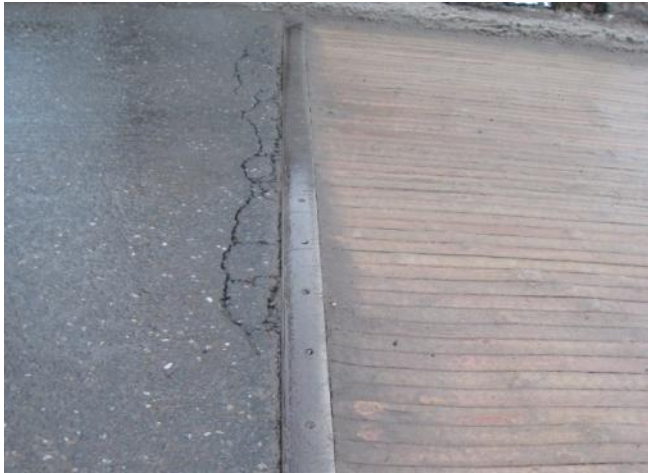
kuva 13. Päällyste on purkautunut liikuntasauvan vierestä
