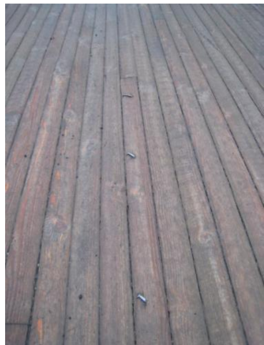
kuva 12. Nauloja on paljastunut kulumisen seurauksena.
