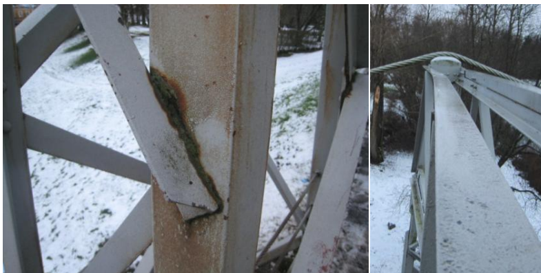
kuva 7a ja b. Pyloneissa on merkittävää ruostumista sekä taipuma
